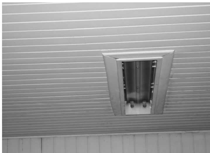
Foto N° 12 – Vista en el cielorraso de la oficina del personal un artefacto de iluminación sin los tubos fluorescentes cosa que se repite en varios lugares en que presentan faltantes de los mismos o están quemados y en todos los casos no tienen los elementos que den seguridad ante la posible caída de los mismos.
