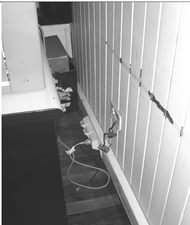
Foto N° 25 – Vista en la oficina del director sobre la pared, dos fichas de un tomacorriente embutido descolgados de la base mostrando los cables de alimentación eléctrica expuestos.
