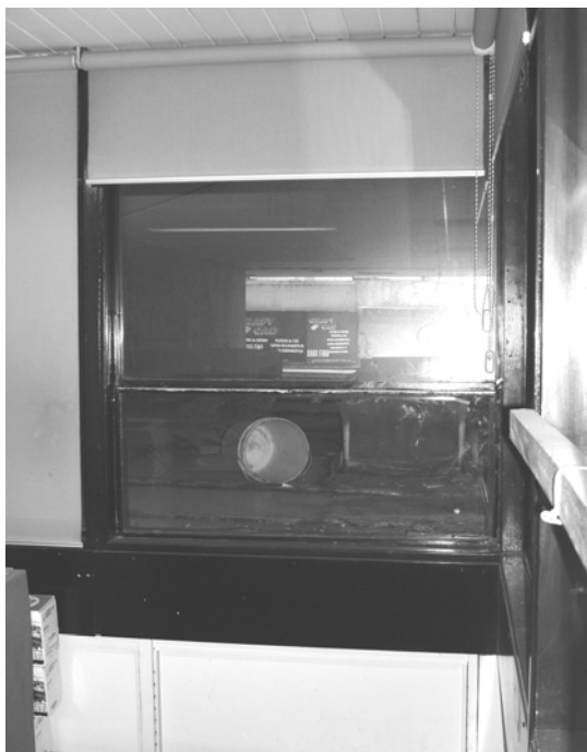
Foto N° 21 – Vista en una oficina la forma que tienen para evitar que puedan abrir las ventanas colocando una madera asegurada con alambres.
