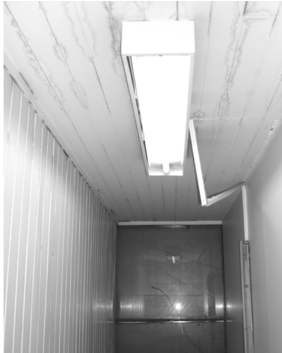
Foto N° 28 – En la escalera se puede observar un cable canal con los cables de alimentación a los tubos fluorescentes descolgados.
