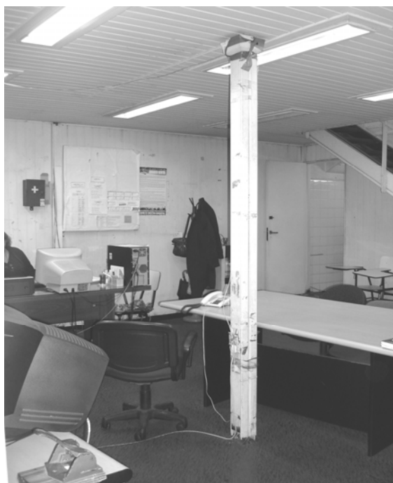
Foto N° 13 – Vista del interior de la oficina de este Organismo donde observamos en una columna varios tomacorrientes eléctricos adheridos con cinta engomada a la misma, como así también los cables expuestos que los alimentan y que en parte bajan colgados desde el cielorraso. Al fondo en el techo se observan toda una franja junto a la pared con huellas de humedad de una filtración de agua desde el piso superior.
