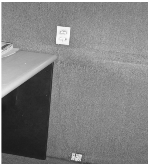
Foto N° 32 – Vista en la oficina de planta baja un tomacorriente alimentado eléctricamente desde una llave de corte por cables expuestos exteriores apoyados en el revestimiento de alfombra de la pared.
