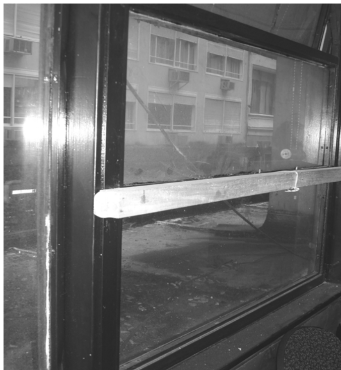
Foto N° 24 – Vista en la oficina del Director una ventana con un vidrio rajado asegurada por medio de una madera atravesada colocada con alambres. La vista exterior muestra basura y suciedad en el piso.
