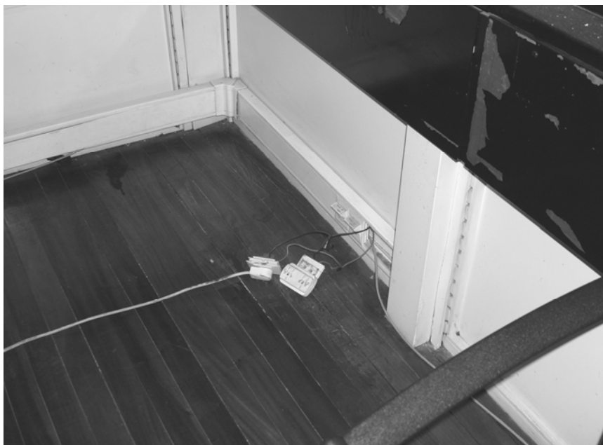
Foto N° 23 – Vista en la oficina del Director dos tomacorrientes fuera del lugar apoyados en el piso y alimentados por cables expuestos.
