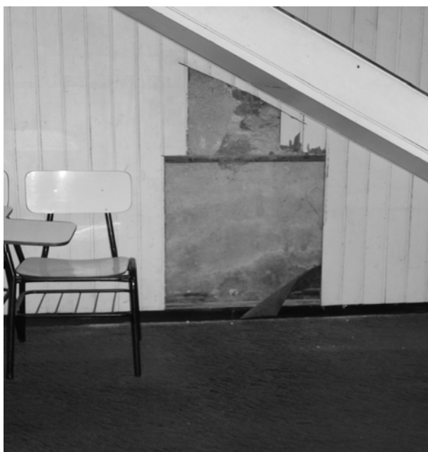
Foto N° 16 – En la, presente vista se puede observar en la pared bajo la escalera que conduce al entrepiso que falta parte del revestimiento de madera que fue retirado por gente de mantenimiento para investigar una filtración de agua, la pérdida no se arreglo pues es un caño del baño que está del otro lado y tampoco arreglaron las maderas retiradas de la pared.
