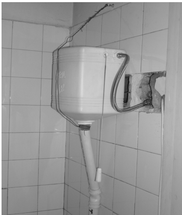
Foto N° 17 – Vista en el interior del único baño para damas y caballeros, observamos que el depósito de agua a cadena del inodoro sostenido desde la pared por alambres (reemplaza al depósito embutido de origen) y a la derecha del depósito la entrada de agua con un caño flexible que se conecta al caño de alimentación dentro de la pared. Para realizar esta conexión se rompieron los azulejos y se abrió un boquete en la pared, nunca se efectuó la reparación de la mampostería y la colocación de los azulejos.
