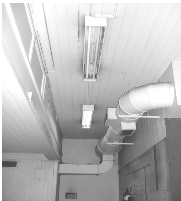
Foto N° 15 – Vista en el cielorraso de la oficina del personal dos artefactos de iluminación uno con los dos tubos fluorescentes quemados y el otro con un tubo quemado cosa que se repite en varios lugares en que presentan faltantes de los mismos o están quemados y en todos los casos no tienen elementos que den seguridad ante la posible caída de estos. En la pared del fondo se puede ver el tablero de electricidad sin tapa y sin la llave de corte diferencial.
