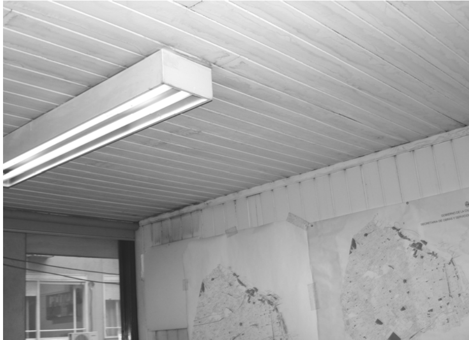
Foto N° 29 – En la oficina del Director se observa en el cielorraso junto a la pared marcas de humedad de una filtración de agua desde el nivel superior.
