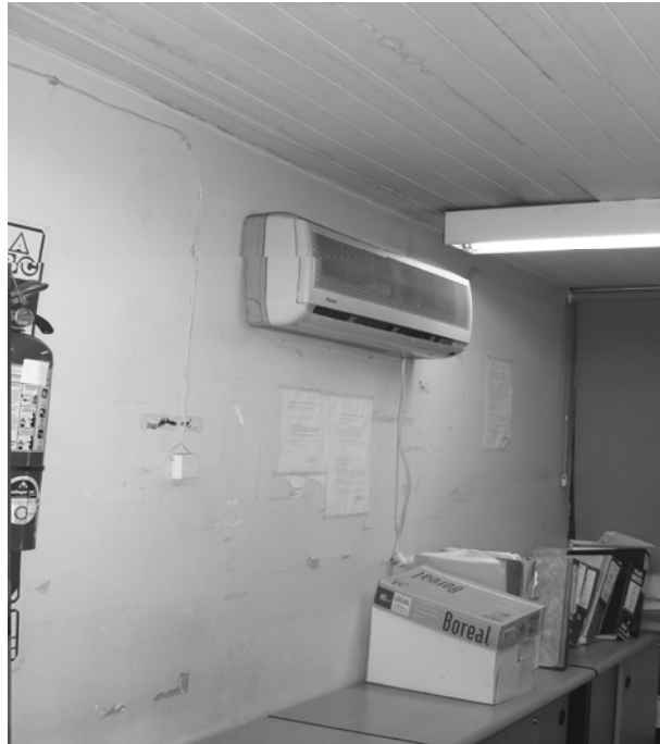
Foto N° 27 – En la oficina del entrepiso se puede observar un tomacorriente eléctrico exterior alimentado por un cable expuesto.
