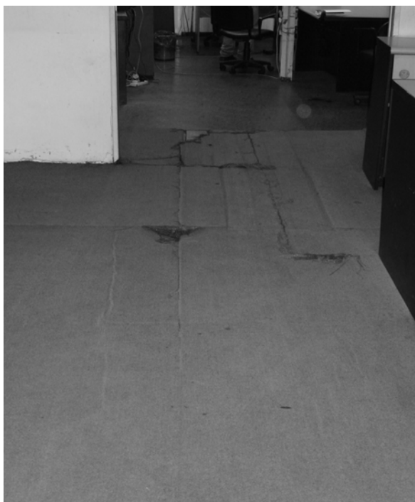
Foto N° 8 – Detalle del piso alfombrado sobre madera flotante el que presenta algunas tablas hundidas y rotas con el consiguiente peligro para las personas que pasan por este lugar.
