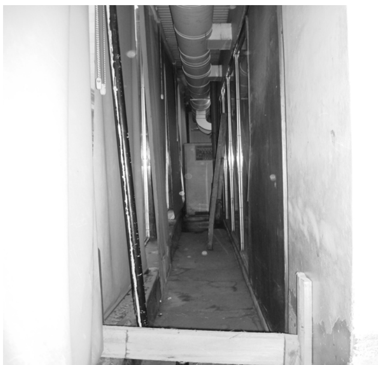
Foto N° 6 – Dentro del Organismo podemos observar un pasillo en planta baja determinado por un cerramiento cuyo lateral izquierdo forma frente con la calle Carabelas (donde dos de estos vidrios están rotos) y el otro da al interior de la oficina de la entrada, el ancho es de 0,75 metros y conectaría el hall de la entrada con la oficina del personal, aunque en la práctica está anulado y las visuales al exterior tapadas con cartones, lo mismo se puede ver desde el interior. Es de notar la suciedad que hay en el mismo donde además se depositan elementos en desuso.
