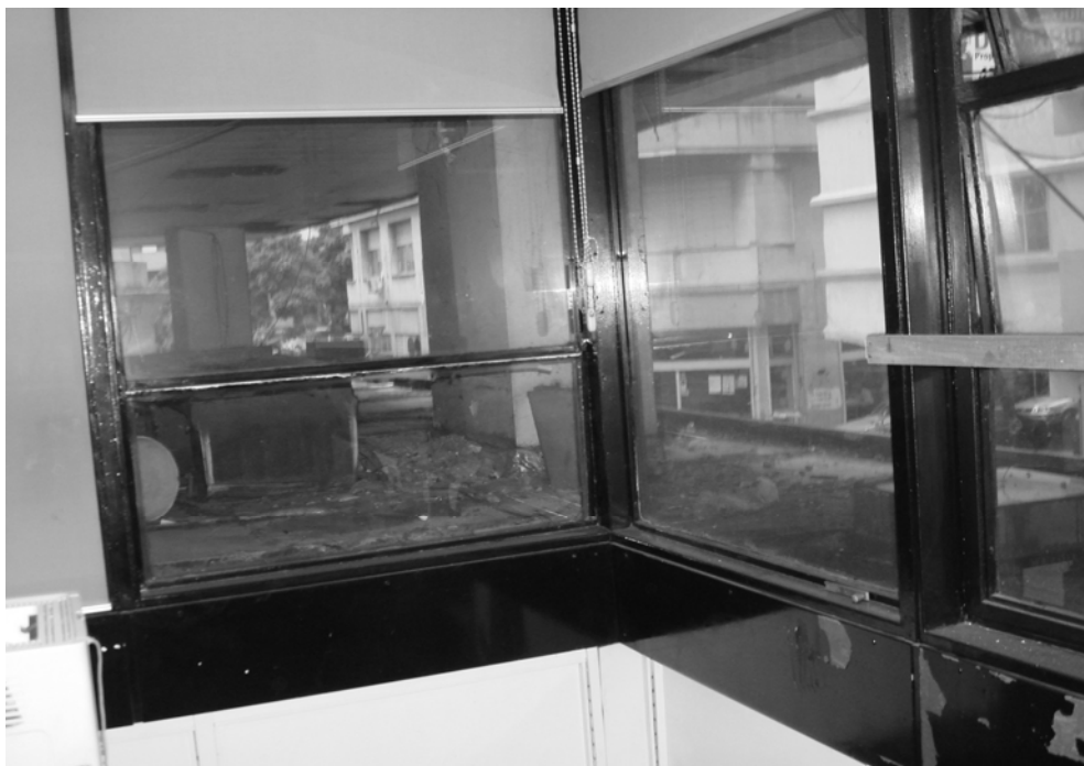
Foto N° 22 – Vista en la oficina del entresuelo la forma que tienen para evitar que puedan abrir las ventanas colocando una madera asegurada con alambres. Es de notar el desorden y la suciedad que se puede ver en el exterior de esta oficina que da a un espacio muerto en el nivel sobre la planta baja, a este espacio los ladrones acceden desde la reja de la entrada al Organismo.
