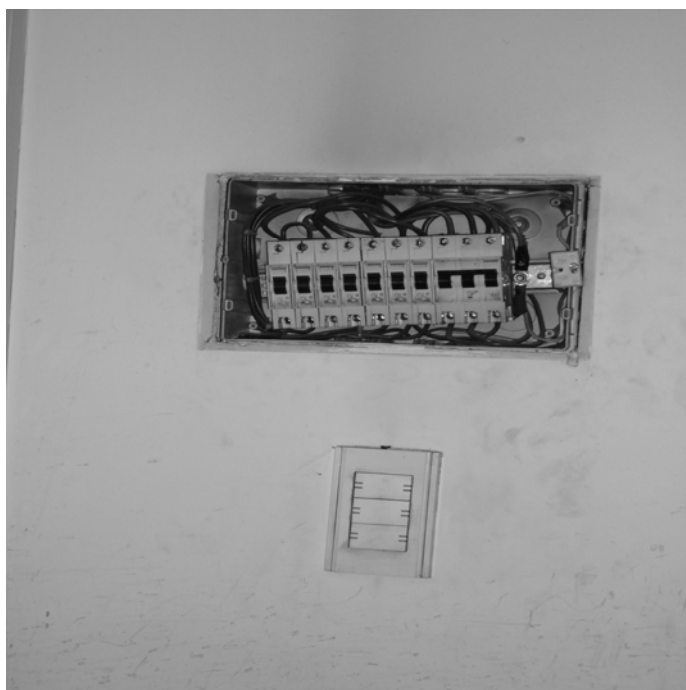
Foto N° 20 – Vista del tablero de electricidad seccional sin la tapa correspondiente, mostrando las conexiones (que son cables de electricidad expuestos y encintados).
