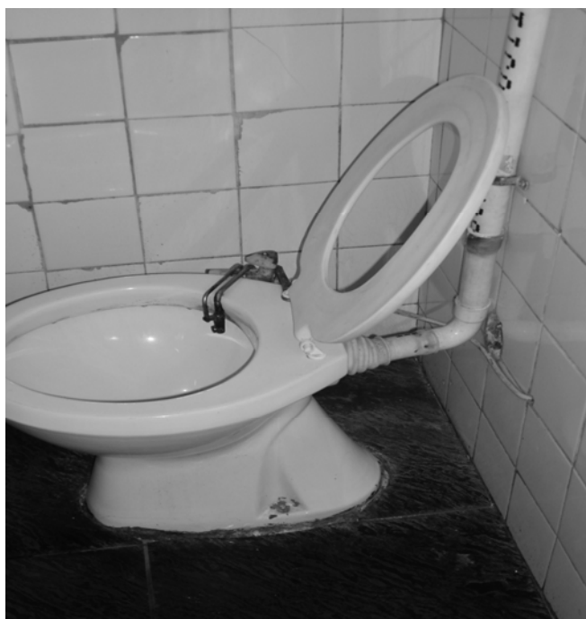
Foto N° 18 – Vista en el interior del único baño para damas y caballeros, la alimentación de agua baja desde el depósito mediante un caño exterior y en la pared quedó la salida del anterior caño embutido sin arreglar.
