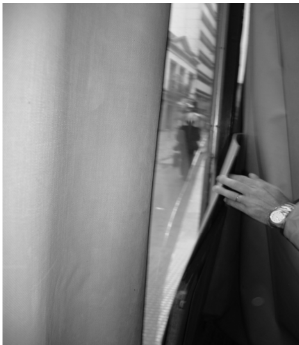
Foto N° 31 – Vista en planta baja, un vidrio rajado de la vidriera que da al pasaje Carabelas tapado con cartones.
