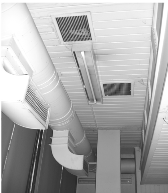
Foto N° 14 – Vista en el cielorraso de la oficina del personal dos artefactos de iluminación con los tubos fluorescentes quemados cosa que se repite en varios lugares en que presentan faltantes de los mismos o están quemados y en todos los casos no tienen elementos que den seguridad ante la posible caída de estos.
