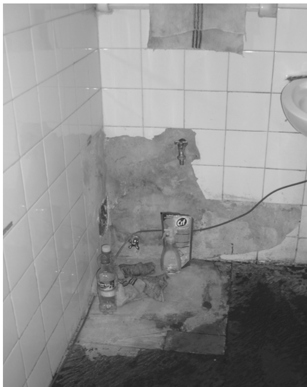
Foto N° 19 – Vista en el interior del único baño para damas y caballeros en un rincón podemos ver arreglos efectuados en el piso y la pared sin colocar los revestimientos correspondientes y un cable de electricidad expuesto que atraviesa este lugar.
