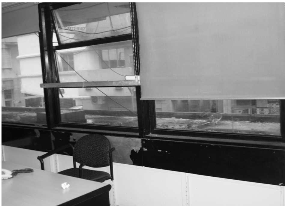
Foto N° 26 – Vista en la oficina del Director una ventana con un vidrio rajado asegurada por medio de una madera atravesada colocada con alambres. La vista exterior muestra basura y suciedad en el piso.
